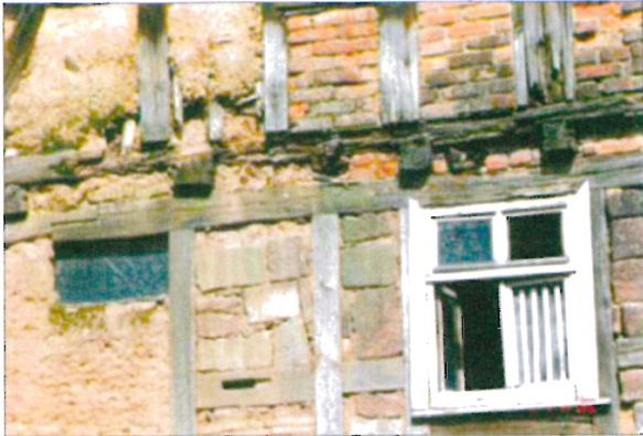
Bild 11: Stockwerk-Rähm mit Balkenköpfen fast vollständig zerstört
