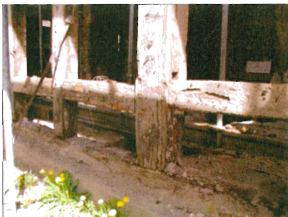
Bild 9: Schwelle mit zerstörten Ständerfüßen
