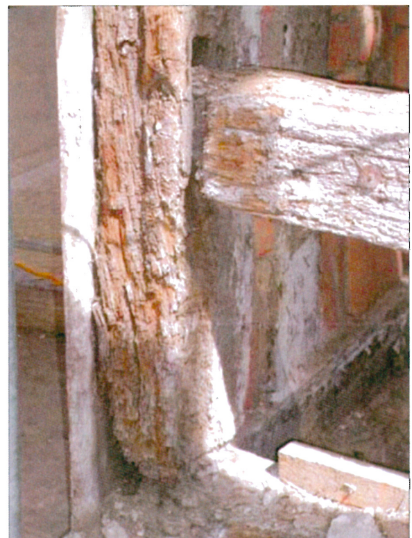
Bild 10: Zerstörte Schwelle, zerstörter Eckständer und Riegel
