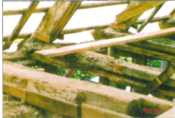
Bild 6: Holzerstörungen im Bereich der Dachtraufe; Sparrenfüße und Balkenköpfe zerstört
