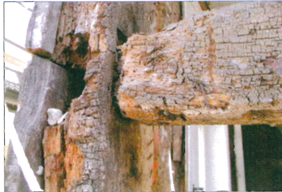
Bild 12: Zapfenverbindung zwischen Ständer und Riegel zerstört
